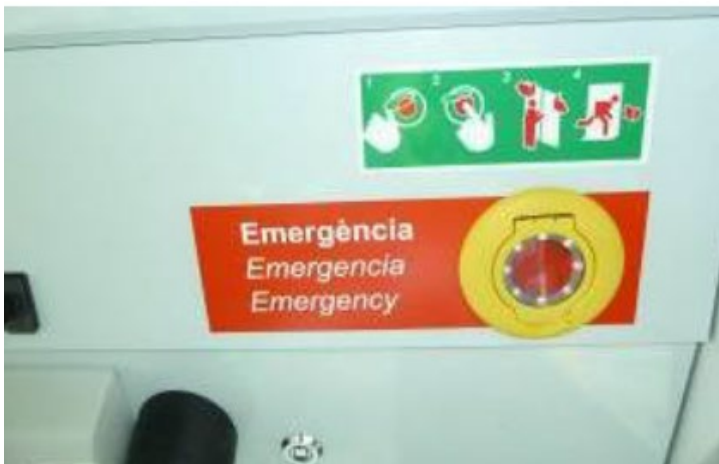
Figura 26. Pulsadores de emergencia
