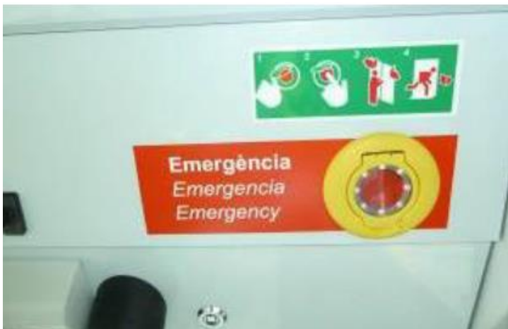
Figura 25. Pulsadores de emergencia
