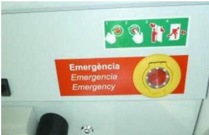
Figura 26. Pulsadores de emergencia
